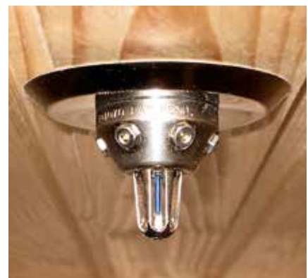
Kuva 66. Korkeapainevesisumujärjestelmän suutin oppoasennettuna asuinkerrostalon kattoon. Kuva: Versowood
