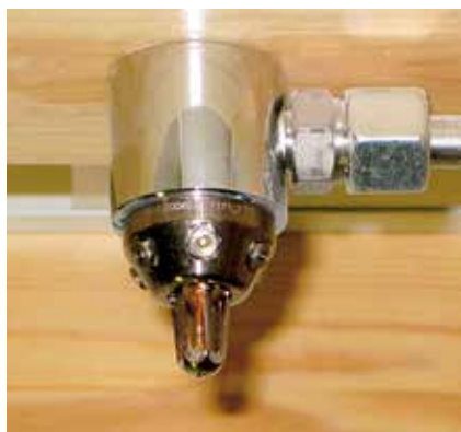
Kuva 65. Korkeapainevesisumujärjestelmän suutin pinta-asennettuna asuinkerrostalon kattoon. Kuva: Versowood
