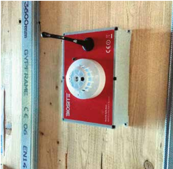
Kuva 58. Rakennustyömaalla käytössä oleva langaton palovaroitinjärjestelmä.
